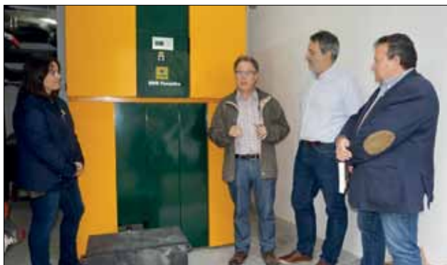
Inauguració caldera de biomassa
